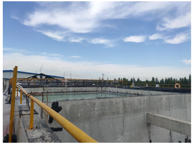
项目污水处理站
