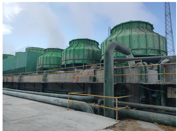
项目循环水池
